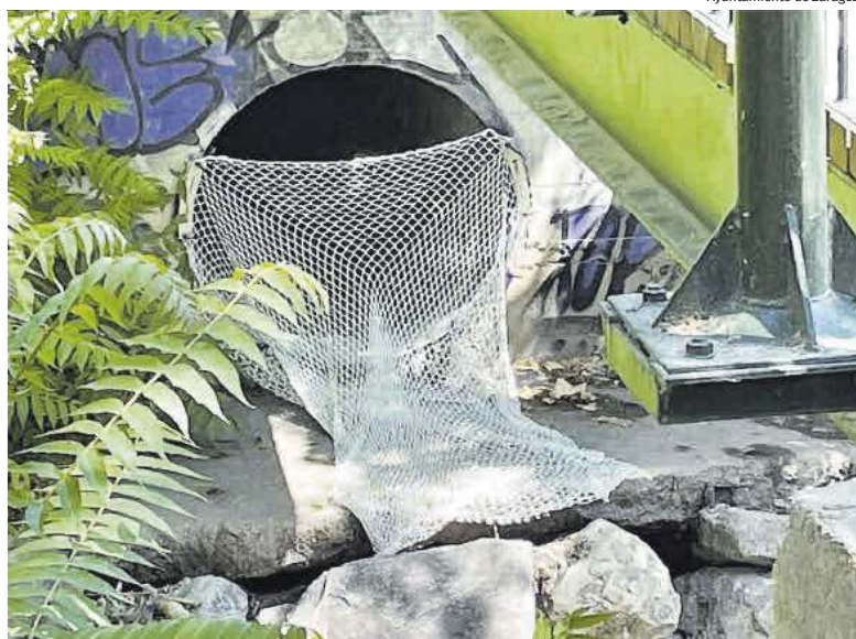
Una de las mallas instaladas en un aliviadero para evitar que los desechos lleguen al río.
