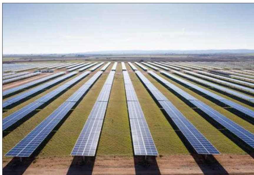
Planta fotovoltaica desarrollada por Cox. EE
